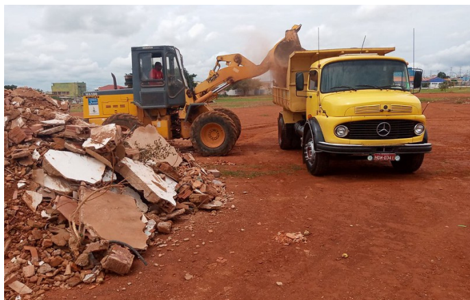
Recolhimento de entulhos descartados em áreas públicas de Samambaia
