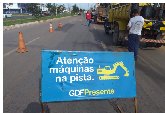
Tapa-buraco nos trechos 4 e 7
