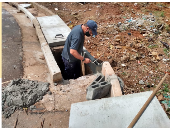
Colocação de tampas e desobstrução de bocas de lobo na ADE do Setor P Sul
